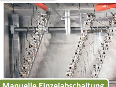
Manuelle Einzelabschaltung durch Absperrhähne
