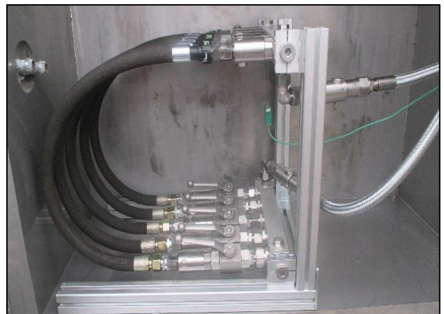
Aufbau in der Prüfkammer
